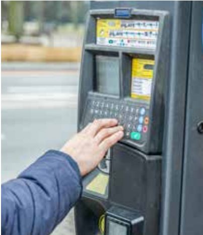
In der Tiefgarage in Tisens wird ein Parkautomat aufgestellt.
